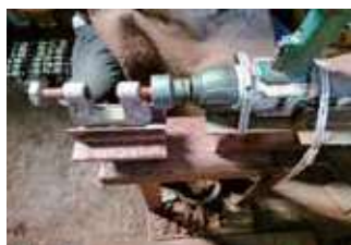
③ボルト回転確認・注油
